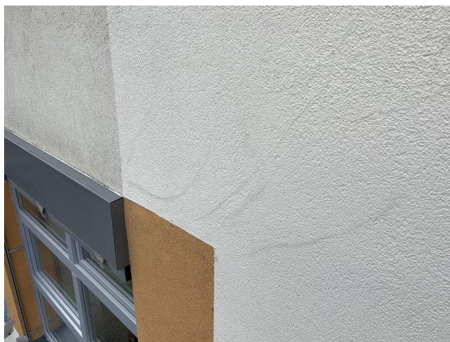
foto /14/ Trhliny v místě nadpraží oken
