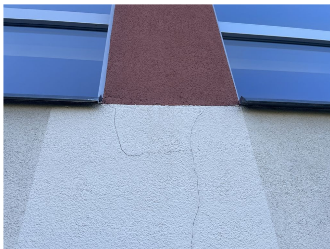
foto /10/ Trhliny v místě parapetů
