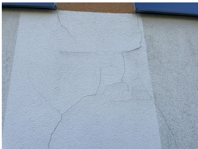
foto /11/ Trhliny v místě parapetů a nadpraží oken
