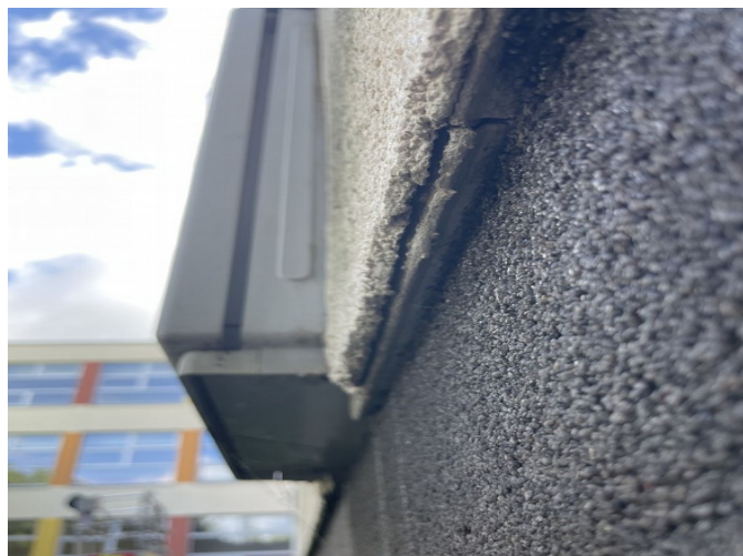
foto /24/ Odtržení základní vrstvy od zakládací lišty v místě soklu
