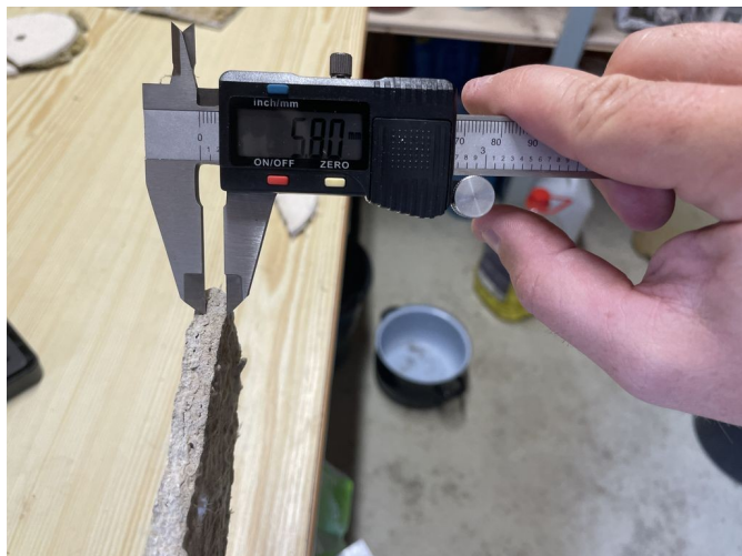
foto /15/ Tloušťka základní vrstvy v sondě S1 (5,8 mm)
