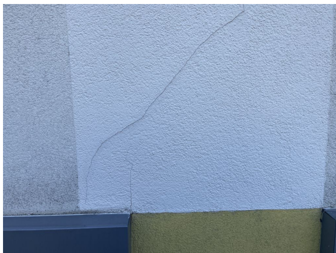
foto /1/ Trhliny v místě nadpraží
