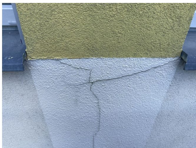
foto /2/ Trhliny v místě parapetů
